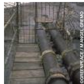
Clausura de tuberías de residuos industriales que durante más de 25 años han vertido más de 1000 toneladas diarias al Mediterráneo en la Bahía de Portman, cerca de Cartagena, España.
