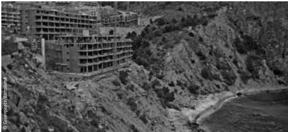
Construcció eliminant pinedes litorals i ocupant el domini públic marítim-terrestre a Altea, Alacant.
