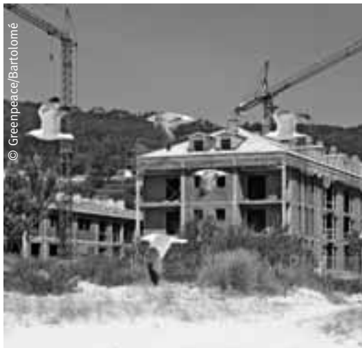
Construcións nas praias de Fisterra, A Coruña.
