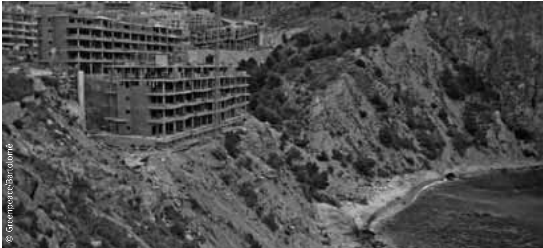
Construcción eliminando pinares litorales y ocupando el dominio público marítimo-terrestre en Altea, Alicante.
