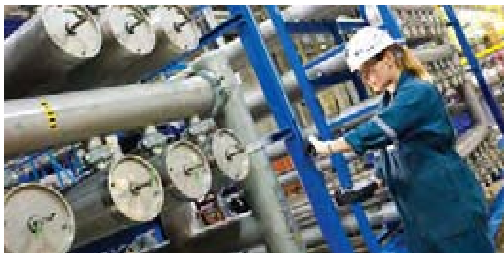
Installation de traitement par osmose inverse de Key Lake
