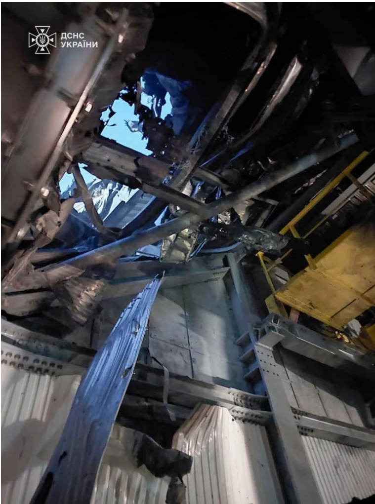
Abbildung 8 (o.): Strukturschäden im Inneren des NSC und an der Wartungswerkstatt für die Hauptkrananlage
