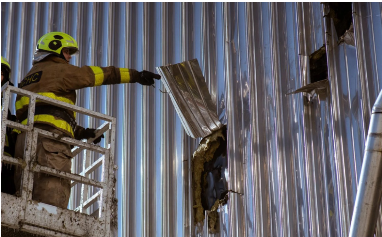
Abbildung 11 (o.): Feuerwehrleute mit mehreren Wasserschläuchen beim Löschen von Schwelbränden
