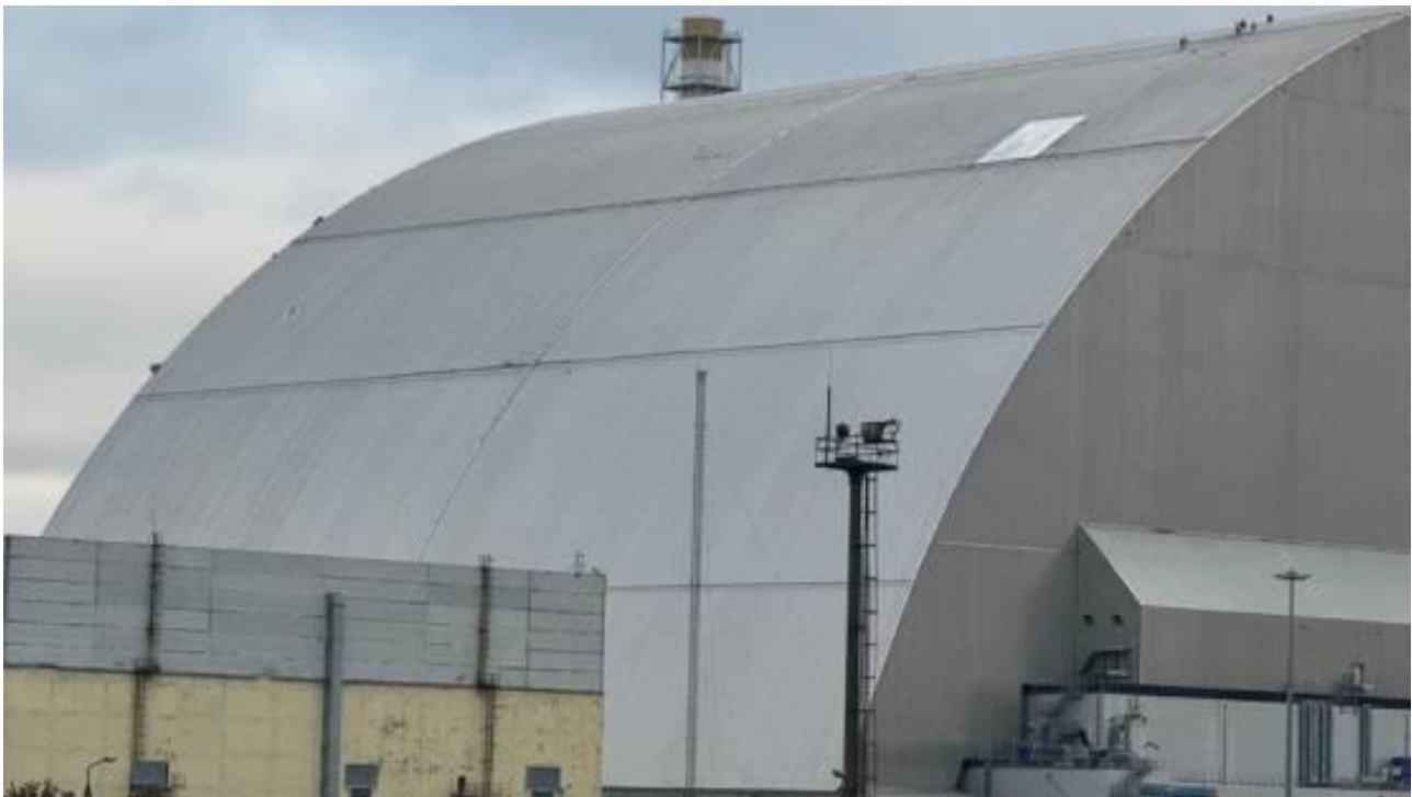
Abbildung 13: Das Dach der Schutzhülle ist nach dem Drohen-Einschlag provisorisch abgedichtet.
