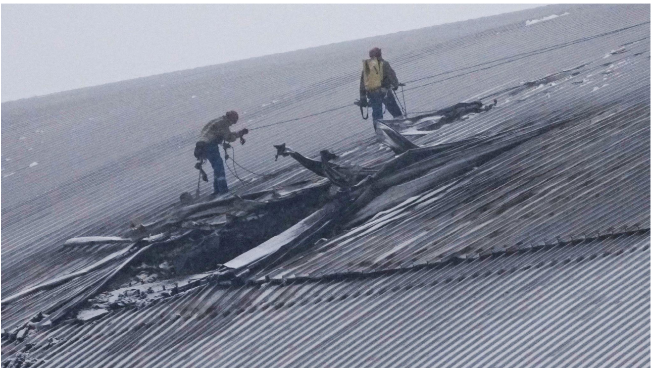
Abbildung 6 (o.): Drohneneinschlagstelle an der Nordseite des NSC, AP von ДСНС
