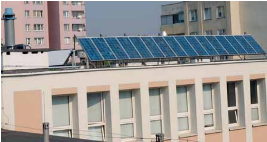
Panele słoneczne na budynku Zespołu Szkół nr 113 z Oddziałami Dwujęzycznymi przy ul. Olgierda w Warszawie. Fot. z archiwum Biura Infrastruktury
