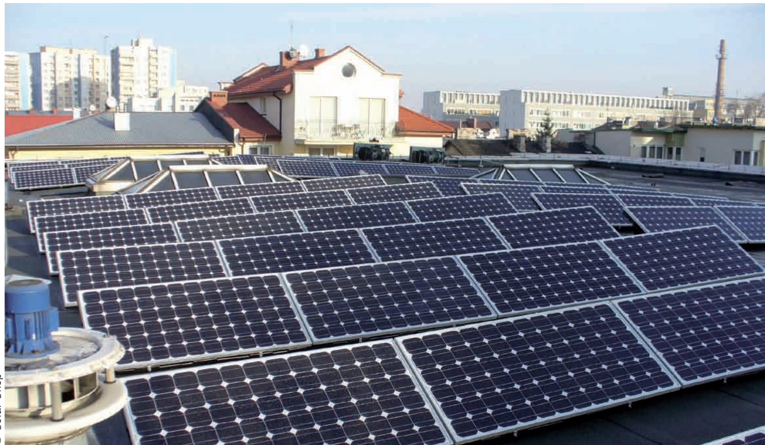
System fotowoltaiczny o mocy 10,5 kWp na biurowcu Euro House, Warszawa
