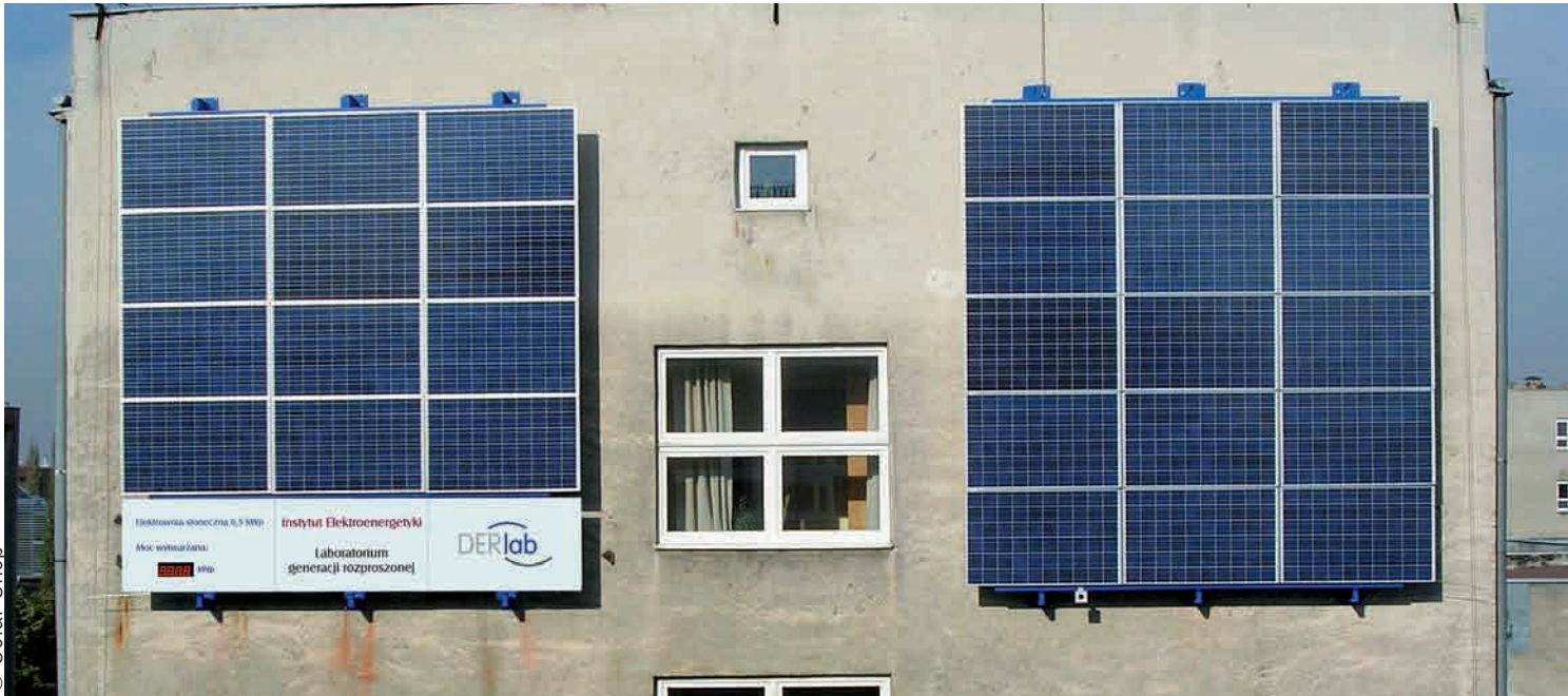
System fotowoltaiczny na Politechnice Łódzkiej, fasada o mocy 6 kWp
