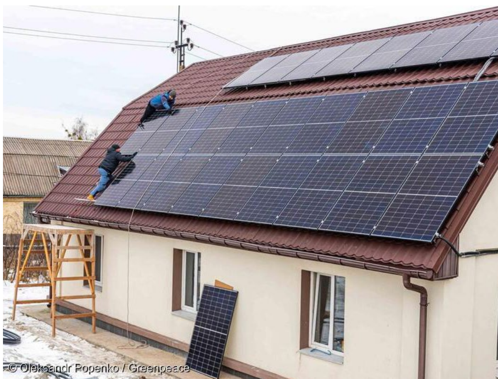
Фото 1. Гібридна сонячна електростанція і тепловий насос в амбулаторії, с. Горенка, Гостомельська громада, Бучанський район, Київська область
